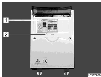
Bild 109 230-V-Sicherungskasten mit Leitungsschutzschalter und FI-Schalter
